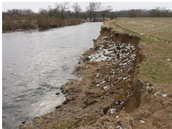
Abbildung 2.48: Einsetzende Seitenerosion nach Entnahme des Uferverbau an der Sieg (eigenes Foto)
