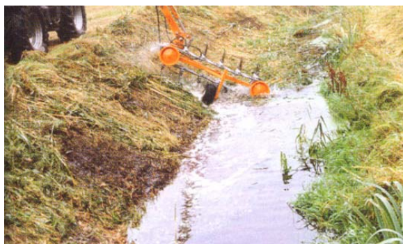
Abbildung 2.41: Bösungsmahd bis ins Gewässer in einem kleinen Bach in Niedersachsen (ATV - DVWK 2002a)
